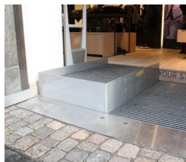
Lift uppe, klar för på-/avkörning
